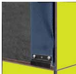
Open voeg in de hoek met EPDM-voegband
